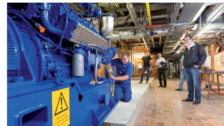
Wartung des Blockheizkraftwerks im Tempelhofer St. Joseph Krankenhaus
